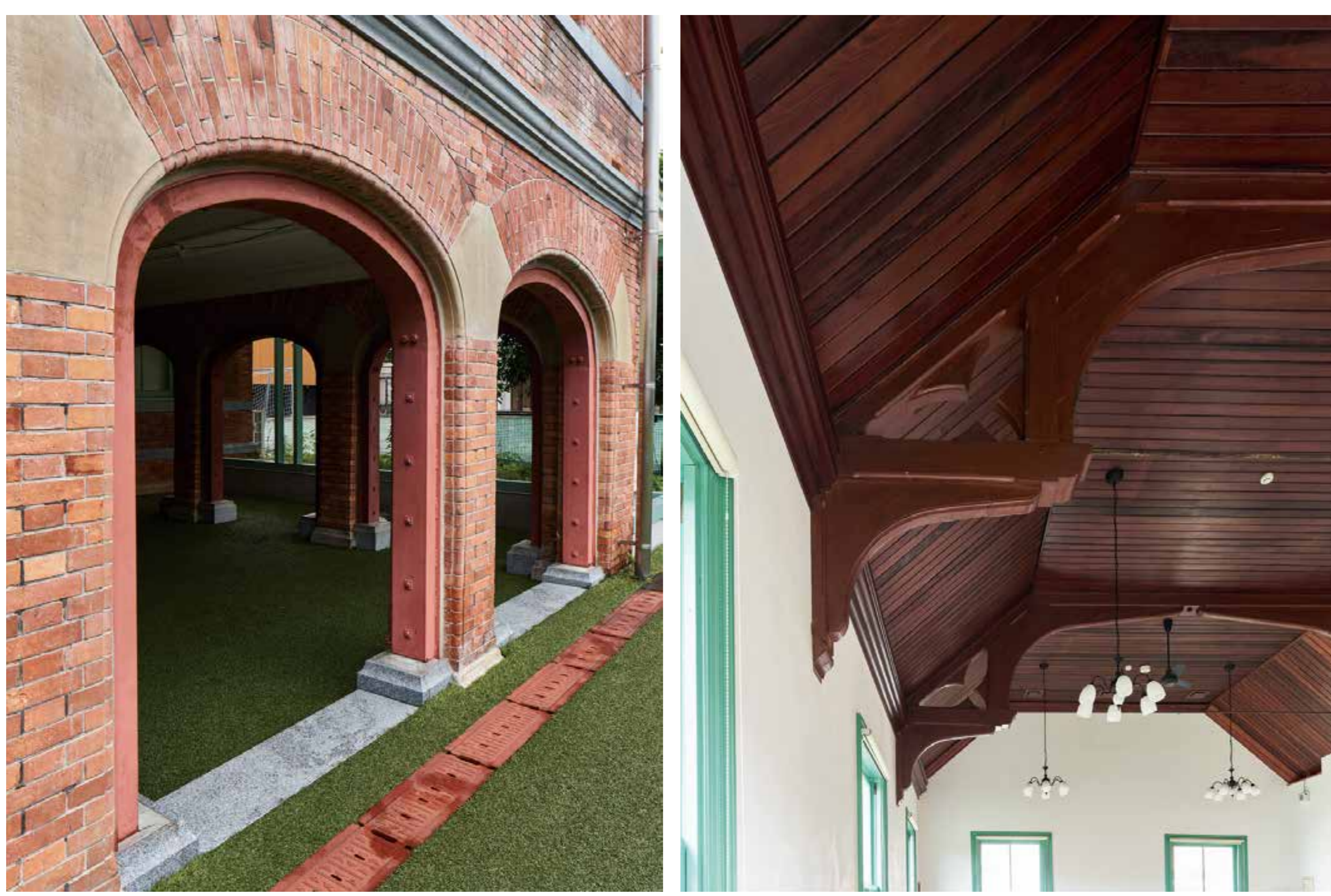
1階南西側の旧雨天運動場。改修により鉄骨で補強された煉瓦アーチ。
